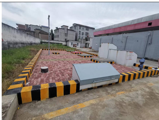
加油站油罐区
